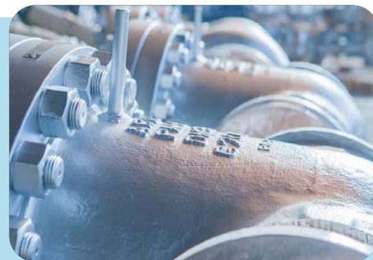
Montage et démontage de brides et d'assemblages filetés, de soupapes de vannes surchauffantes.
